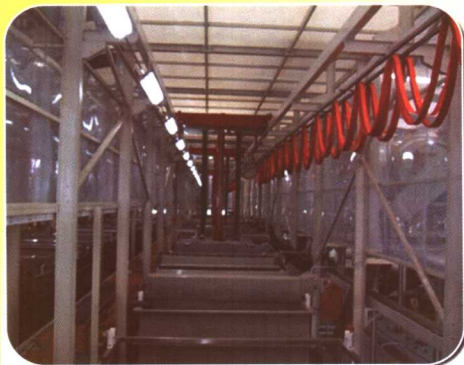
▲ 封闭式天井式电镀生产线
