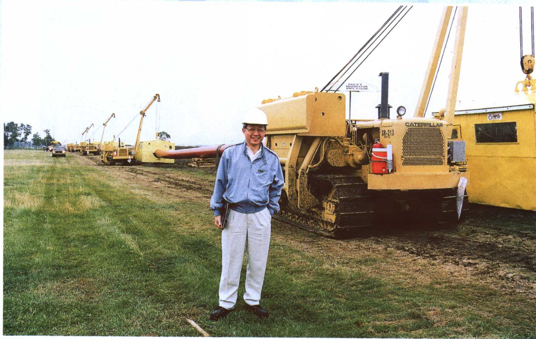
1999年黄志潜访问加拿大，参观加拿大 Alliance 天然气管道施工现场
