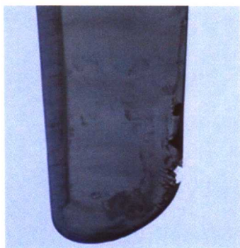
彩图 20 3 号风机叶尖裂纹
