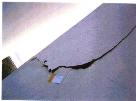
彩图 14 2 号风机叶片裂纹
