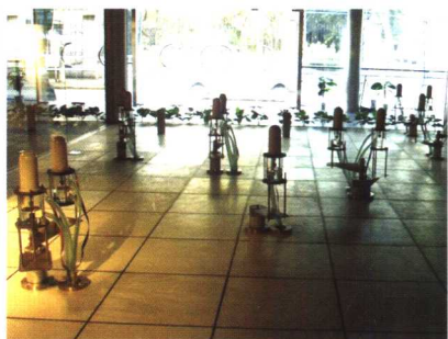
自动化地面沉降监测站。
