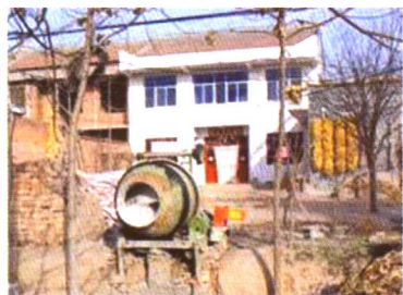
个别工地料场和混凝土拌和系统距群众住宅较近
