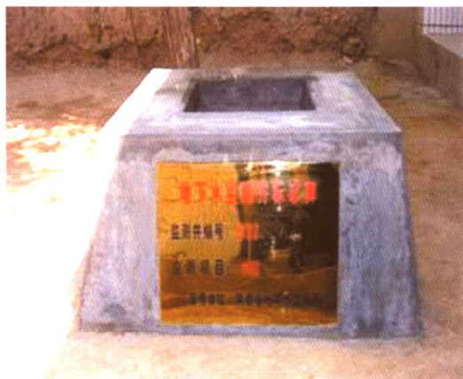
地下水监测井
