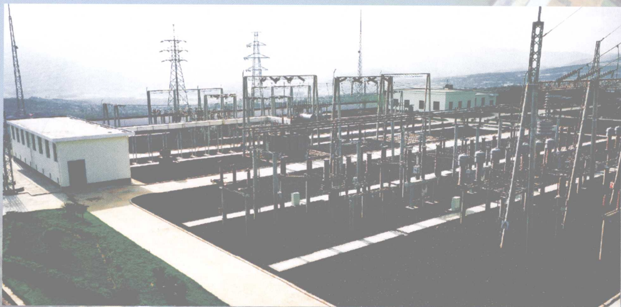
腾冲石头山110千伏变电站
