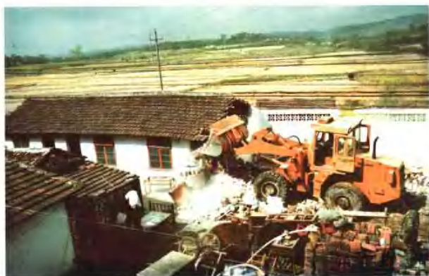
申请人民法院强制拆除违法建筑物
