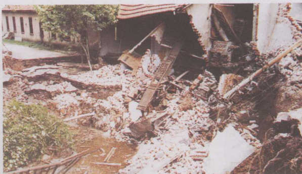
湖北武汉陆家街地陷建筑物受损
