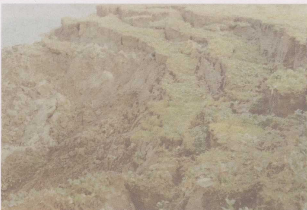
湖北耙铺大堤牵引式滑移型崩岸
