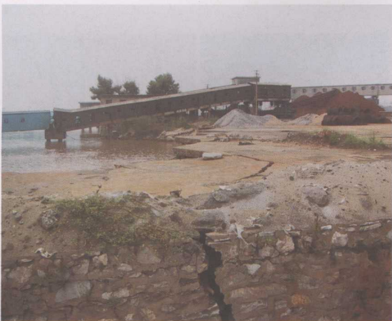
安徽铜陵港第9码头因崩岸产生的裂缝
