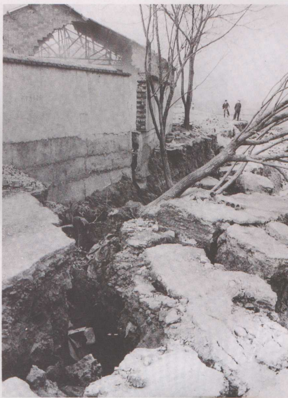
汉江汉阳堤防段发生的严重崩岸
