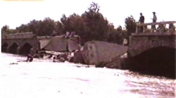
1991年7月24～25日，临沂降暴雨，大桥被冲跨
