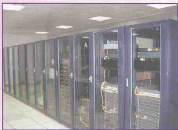
网络中心机房
