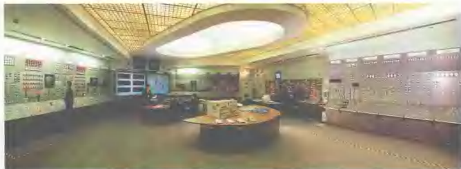
秦山第三核电站主控室，秦山第三核电站工程是中加合作建设的首座商用重水堆核电站。装机容量为2×70万千瓦。1、2号机组分别于2002年12月31日和2003年7月24日投入商业运行。
