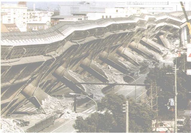
图 1.5 地震毁坏的高架桥
