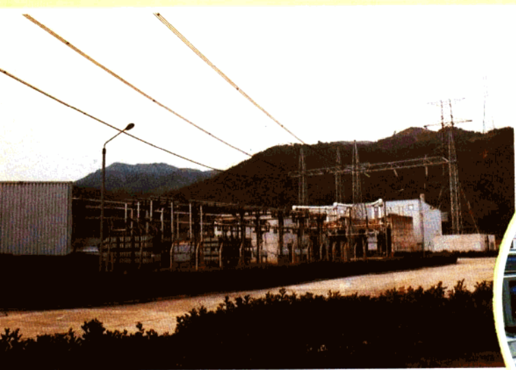
江门五十万伏变电站（杜阮）
