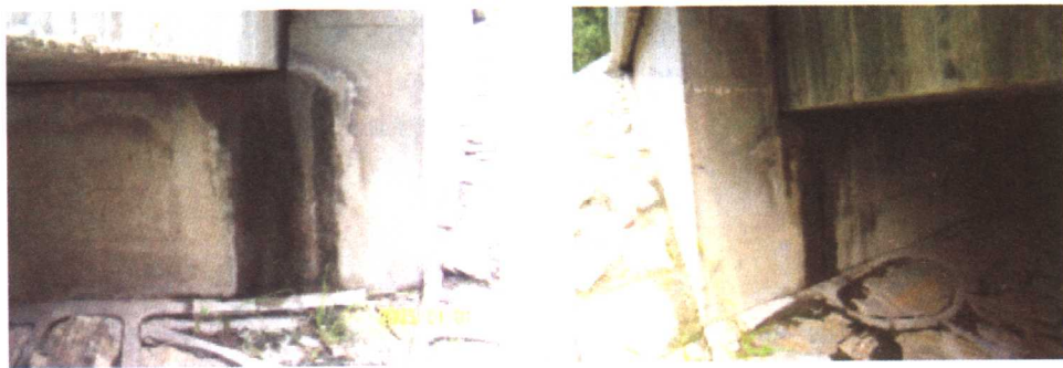
a) 16m 预应力混凝土板桥桥台前墙水迹(伸缩缝漏水引起)
