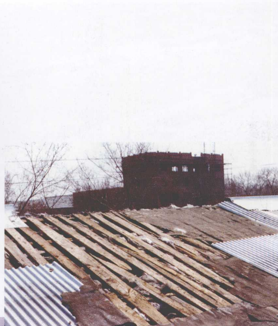
1987年7月29日，飚线，佳木斯市局部分厂房的石棉瓦被刮走
