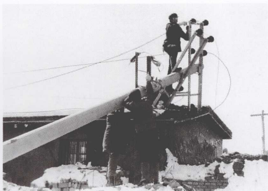
1983年4月29日,齐齐哈尔市境内遭遇了降雪量达25.6~66.9毫米的历史上罕见大风雪,电线被压断,维修人员正在紧张抢修
