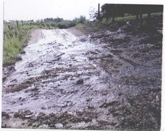
1996年铁力洪水，泥石流冲毁道路
