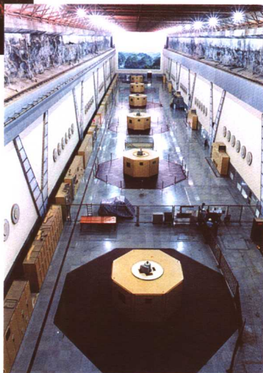
天荒坪抽水蓄能电站主厂房
