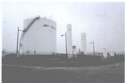
3000m 3 低温液体贮槽
