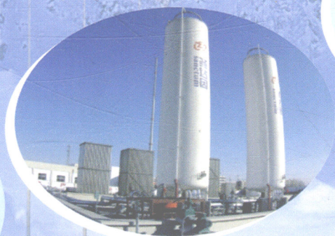
LNG应用工程
