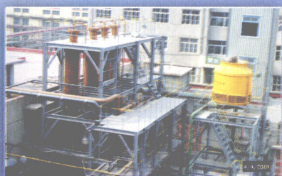
1000m 3 PSA 焦炉煤气制氢装置用于大化公司
