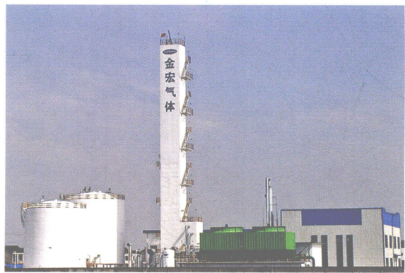
◆ 苏州 3000m³/h 液体空分设备全景
