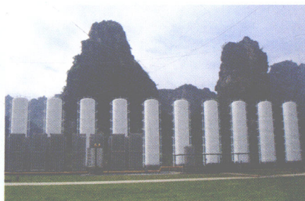
10×100m 3 /d LNG汽化站
