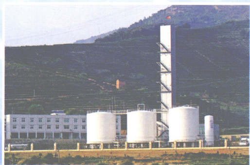
◆ 福建寿宁星耀公司 3500m³/h 液体空分设备全景
