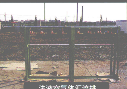
法液空气体汇流排
