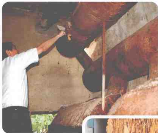
材质差导致换热器严重锈蚀
