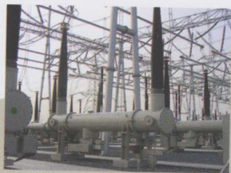
500kV高压断路器
