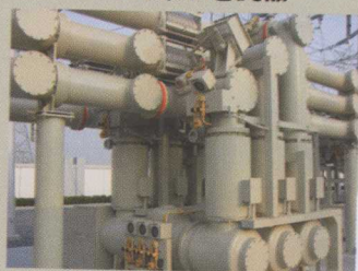
110kV全封闭组合电器
