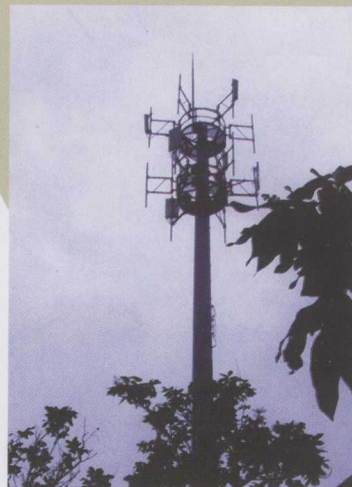
移动通信基站
