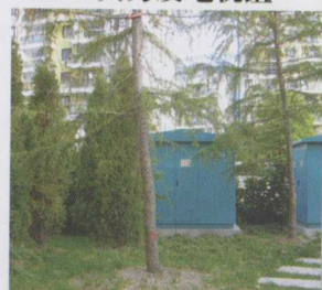
城市小区箱式变电站
