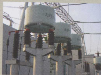
35kV高压电抗器
