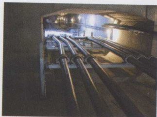
电缆隧道中的110kV地下电缆
