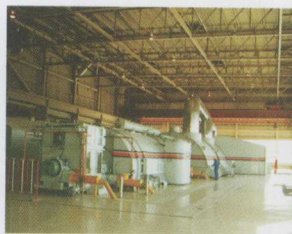
600MW火力发电机组
