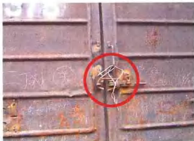
图 1-8 扣铁折断损坏,无法施封
