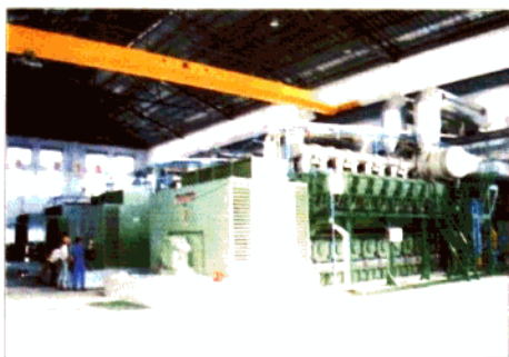
市发电厂机组车间
