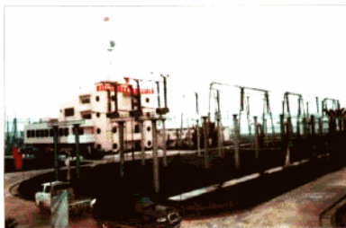
220 千伏三江变电站
