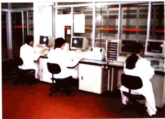
市话 3 万门程控交换机房控制室
