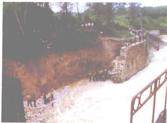
1994年，东兴洪水泛滥，使黄琰水库江尾 副堤及排洪道塌方
