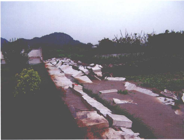
乐昌市气象站观测场围墙倒塌。
