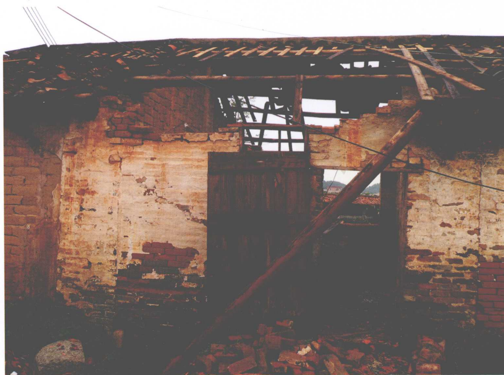
被龙卷风损毁的部分民房。
