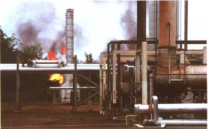
赤道几内亚马拉博郊区的石油和天然气分离设施。
