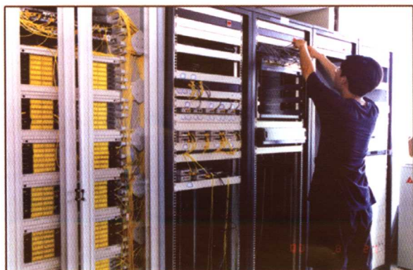
❶ IP城域网机房
