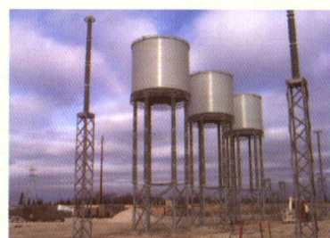
500kV 直流平波电抗器
