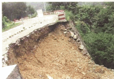
图 1-11 连日暴雨使道路塌方
