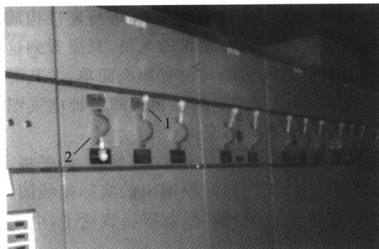
图 1-0-3 安装在低压变电所内的低压配电盘 1—合闸状态手柄的位置; 2—拉闸后的手柄位置
