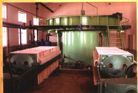
五万吨生产线污水处理系统
