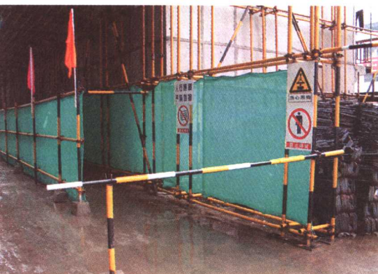
安全通道 (浙江中富建筑集团股份有限公司)
