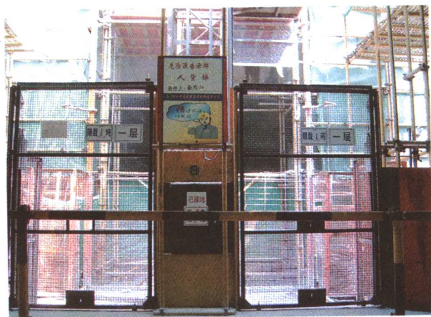
电梯机械设备 (浙江舜杰建筑集团股份有限公司)
