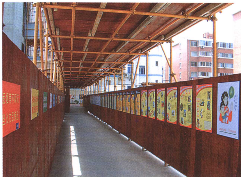
安全通道 (浙江舜杰建筑集团股份有限公司)
