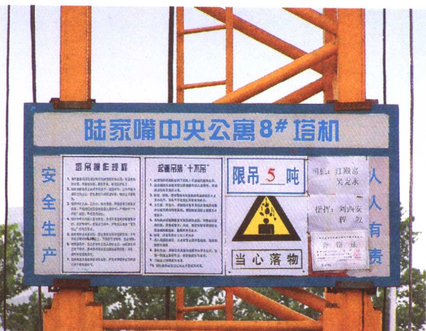
塔机安全信息牌 (中国建筑第四工程局)
