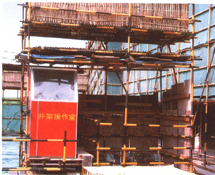
井架操作室 (上海建工集团)
