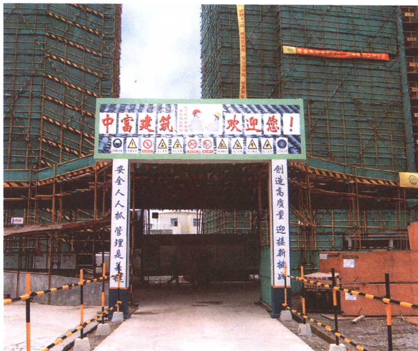
安全通道 (浙江中富建筑集团股份有限公司)
