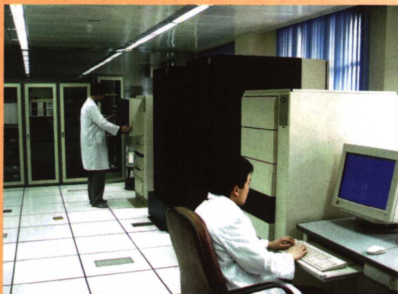
现代化的四川省邮政储蓄计算机中心机房
