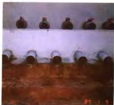
圖20. 水塔出口特寫，下面的階梯可使水源再經曝氣後，更為潔淨。
