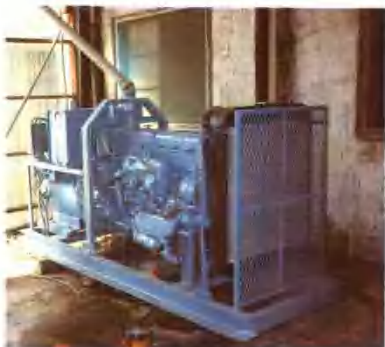
圖27 購自拆船業者的中古型發電機。
