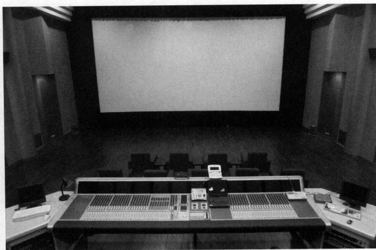
新厂混录棚机房
