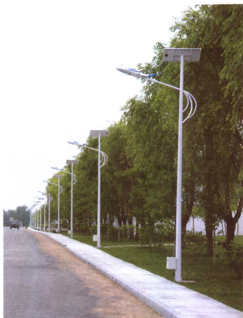
辽宁省丹东市某驻军营区 中的太阳能路灯
