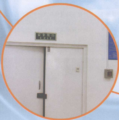
中心机房防火门
