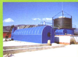
北京巨山农场沼气工程
