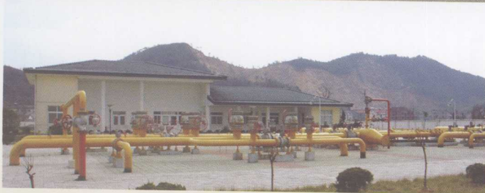
湖州天然气门站
