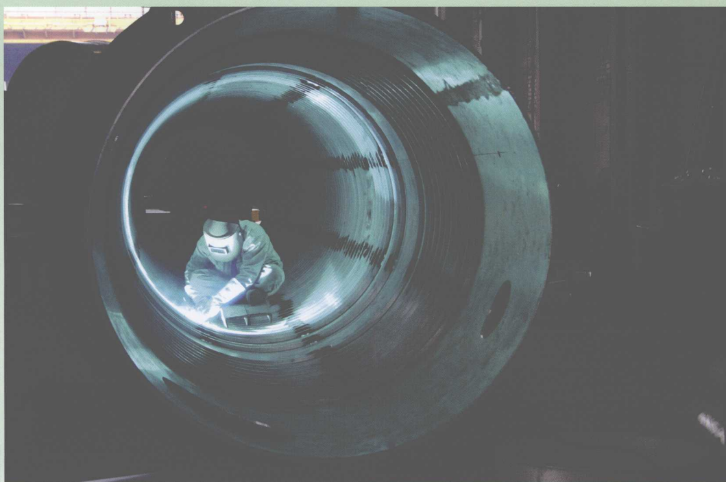
杭州制氧机集团有限公司生产5万立方米空分设备塔体现场
