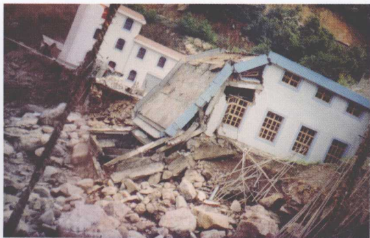
1996年7月9608号台风，连江山仔水库厂房、建筑物被冲毁
