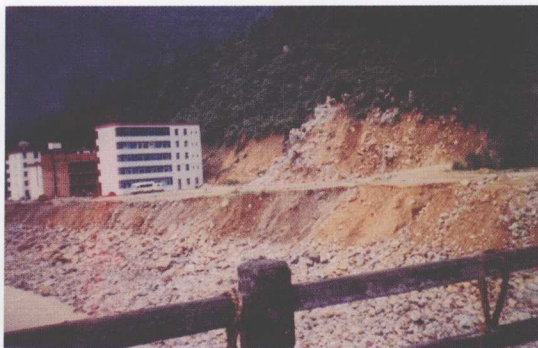
1996年7月31日至8月2日,9608号台风正面袭击福州地区,连江县的北茭、苔篆等乡镇受灾严重,图为山仔水利枢纽施工大桥护坡被洪水冲毁
