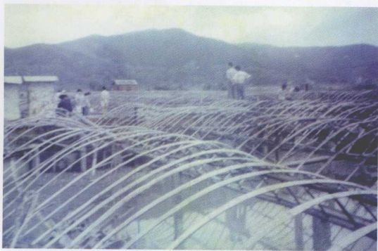
1996年7月9608号台风，连江县东岱、东兴养鳗厂被洪水淹没，大量鳗鱼流失
