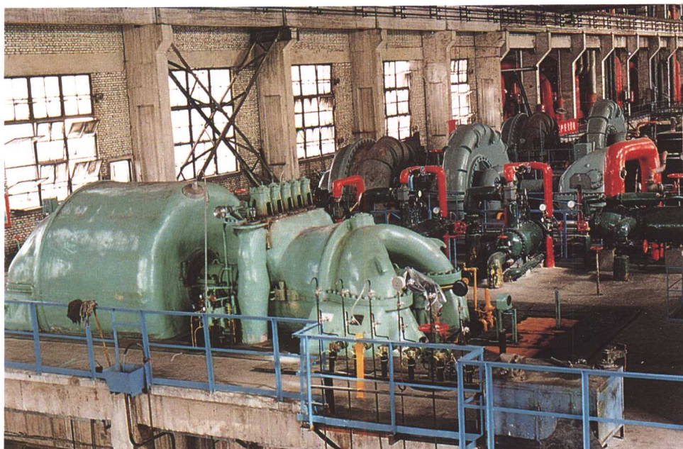
566 立方米空压机热能回收装置（酒泉钢铁公司）
