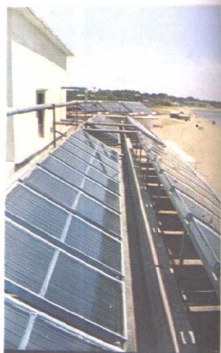
太阳能浴室的 太阳能集热装置
