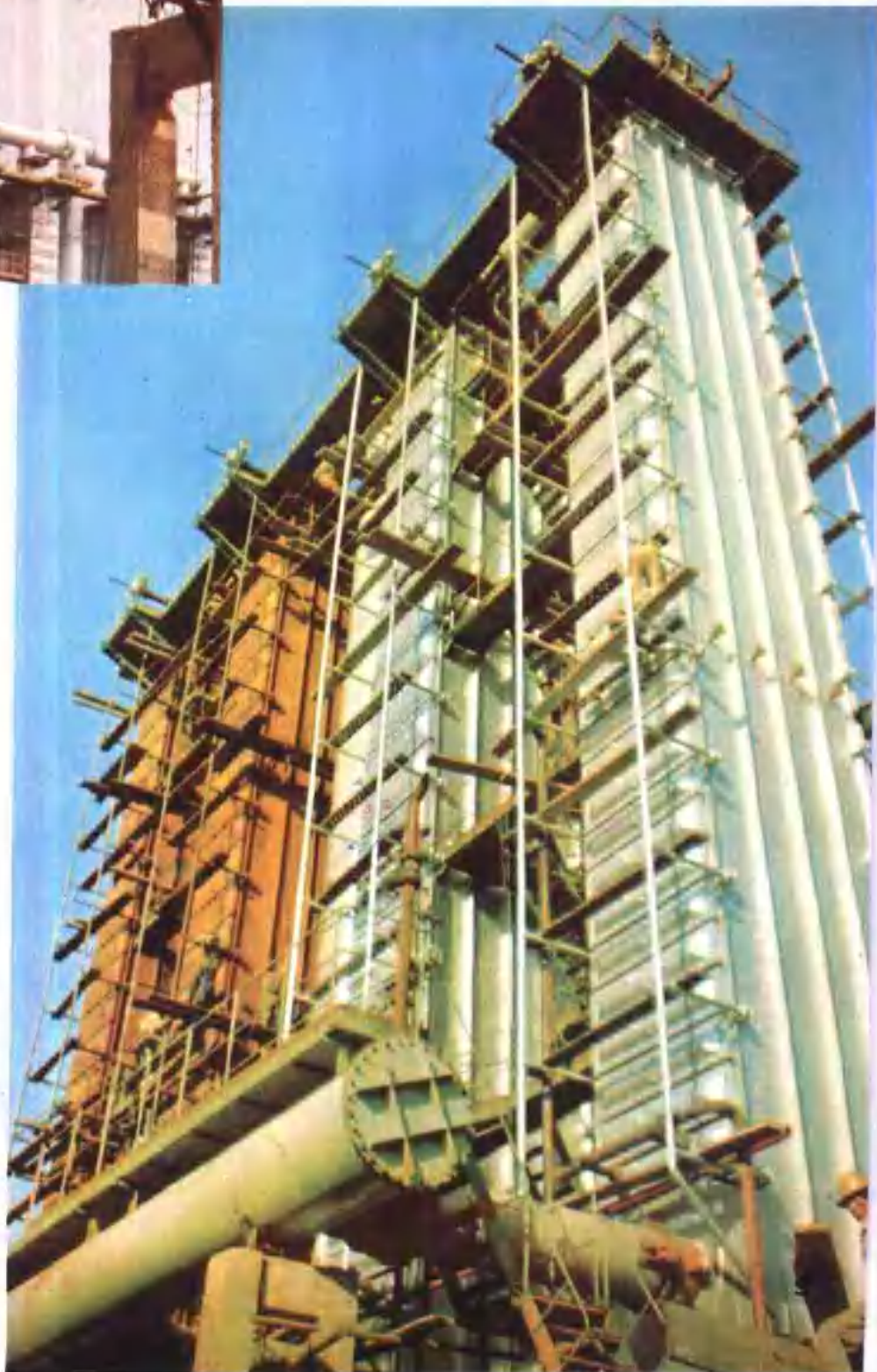
第二煤气厂初冷器。
