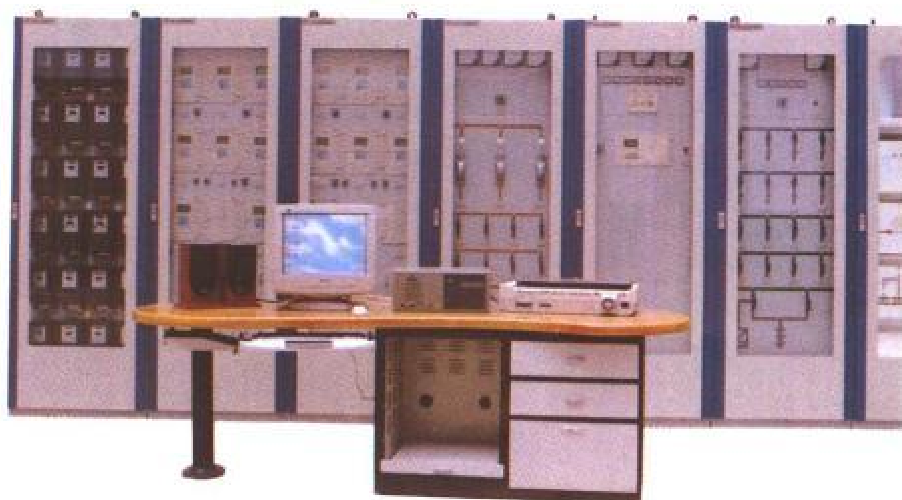
PSU 变电站综合自动化系统
