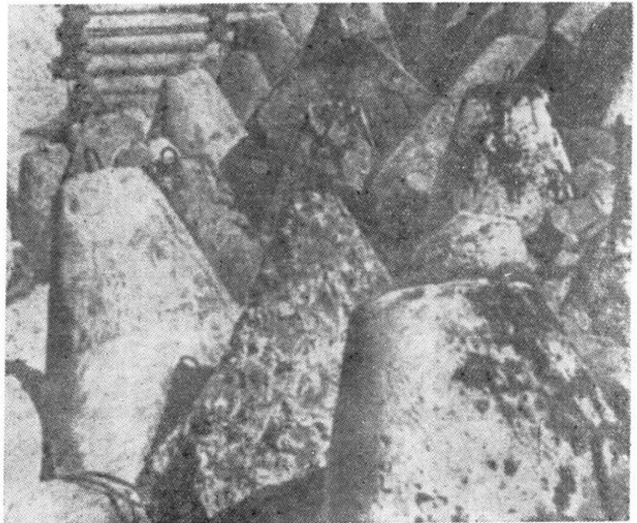
图2.1 由于混凝土的破坏和钢筋的腐蚀，造成沿海护堤的破坏
