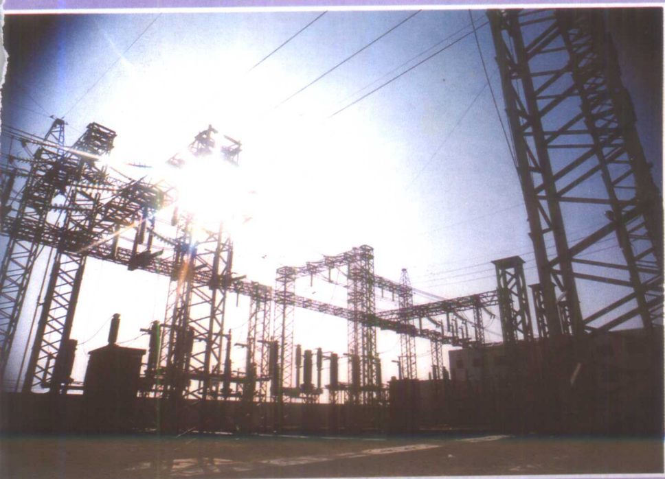
▲ 汕頭市燃機電廠升壓站
