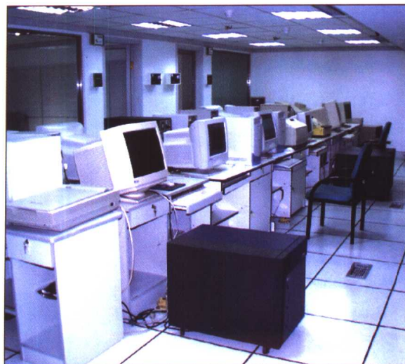
宁波市信息中心机房一角
