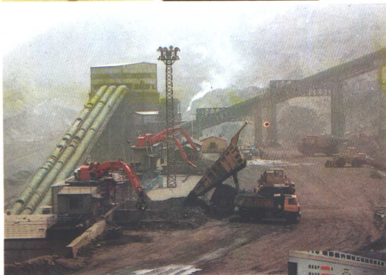
破碎提升系統的 破碎站和緩沖倉
