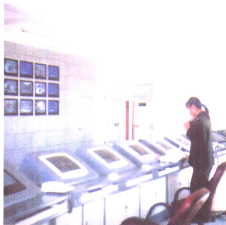
指挥监控中心监控人员在工作
