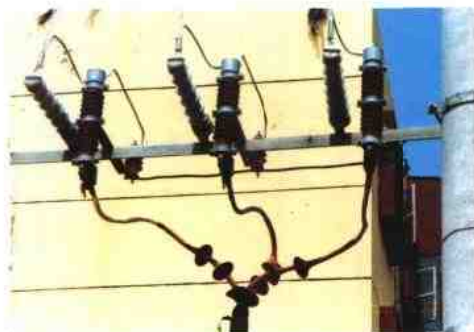
PRW6-12/5-100-6.3 新型喷射式高压熔断器正在运行中
