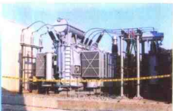
伊朗德黑兰地铁 AEAD 高压站 63/20kV 有载调压电力变压器
